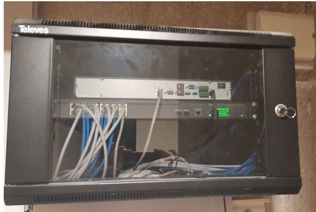
Il·lustració 52 Rack secundari ubicat a la primera planta de la Casa Natal
