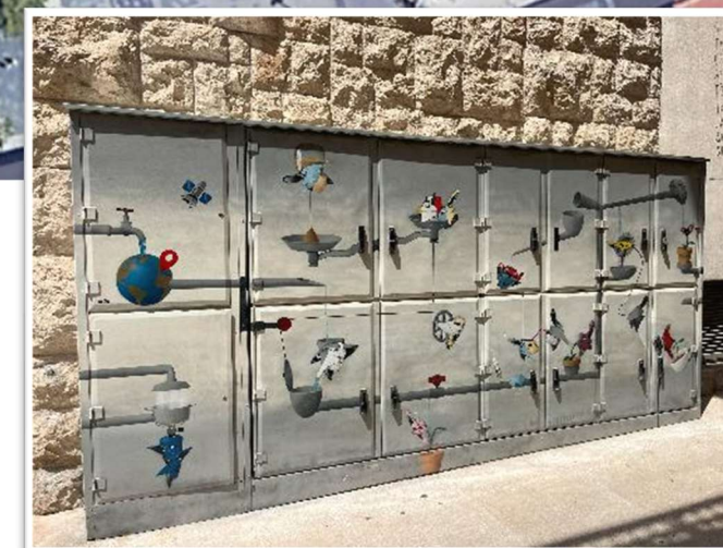
Il·lustració 62: Quadre elèctric Q157
