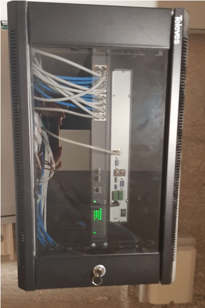
Il·lustració 52 Rack secundari ubicat a la primera planta de la Casa Natal
