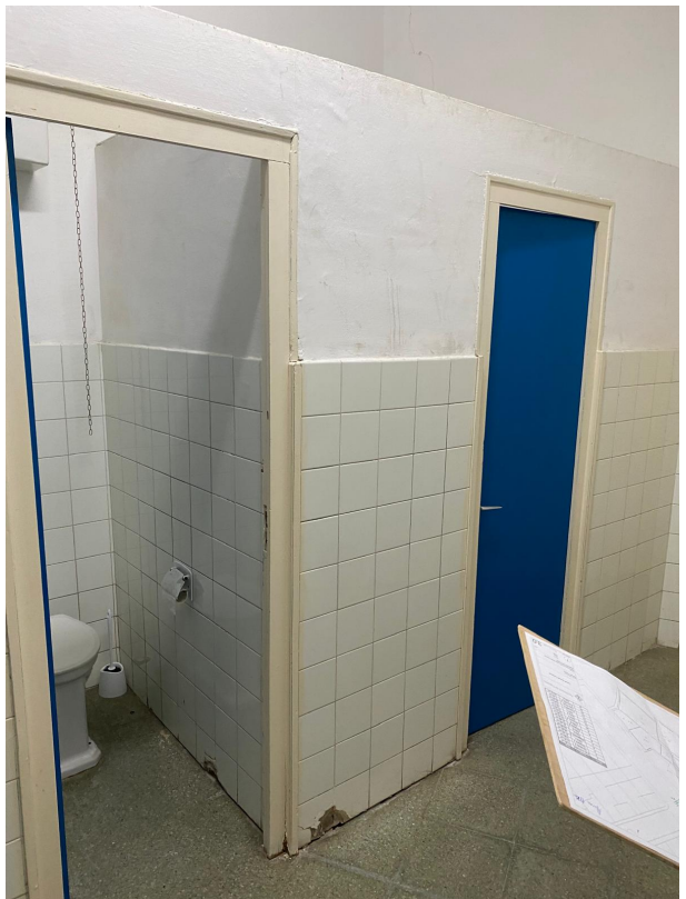
Foto 8. Lavabos a reformar de la part d'Arts Escèniques
